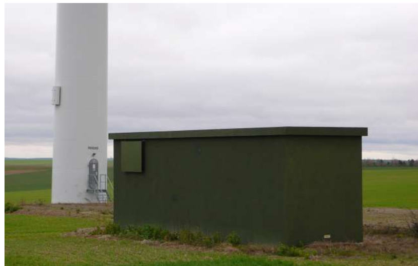
Photo de poste de livraison type
